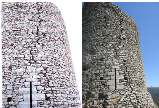
Fissure de la Tour, Clichés Alain Miquel
